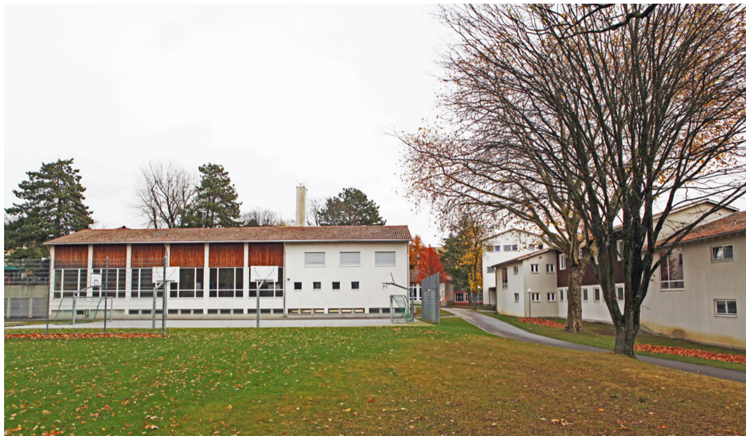
In schlechtem Zustand: Sechs der sieben Pavillons der Schulanlage Geysried, hier die Turnhalle, müssen totalsaniert werden. Lino Schaeren
